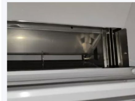
Sistema de control del polvo
